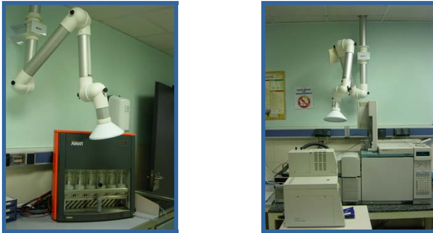
Figura 8. Campanas extractoras localizadas
